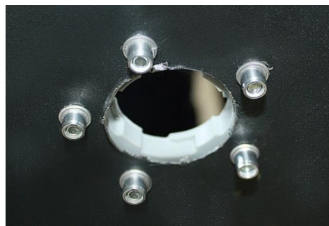
b) aspecto de la placa desde adentro del tanque
