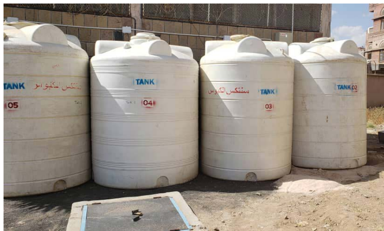
Para el funcionamiento ininterrumpido de los generadores se requieren de 3 a 6 tanques
