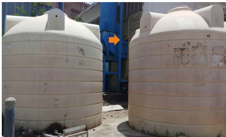
El combustible de los tanques alimenta el generador (→)
