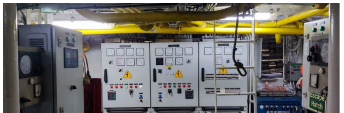
Generadores y panel de control de administración de energía
